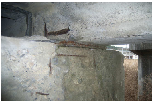
塩害が原因と推定される損傷事例
