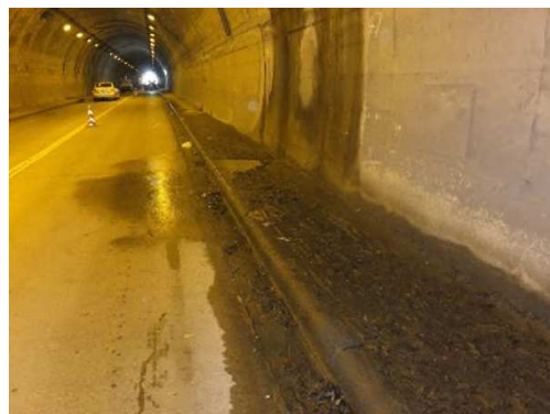
漏水の例(路面に水溜まりがある)
