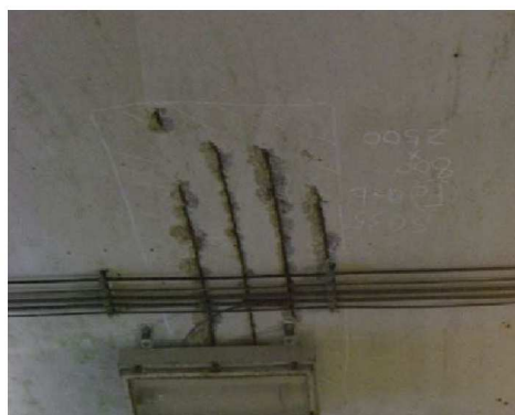
鉄筋がサビている例
