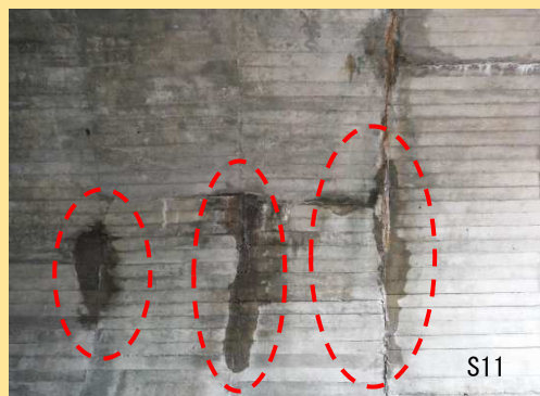
小袖第二号隧道の入口付近に発生した漏水。監視を継続する。
