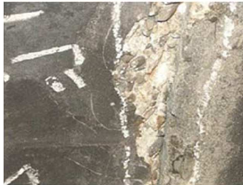
コンクリートのうき・はく離の例
