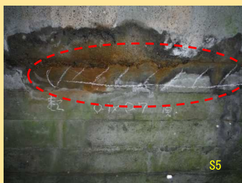
小袖第一号隧道に発生したコンクリートうき。監視を継続する。
