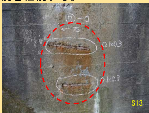
小袖第一号隧道の坑門工に発生したコンクリートうきと鉄筋のサビ。監視を継続する。
