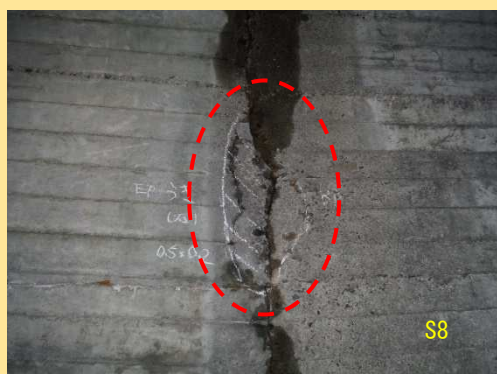
小袖第二号隧道に発生したコンクリートうき。監視を継続する。
