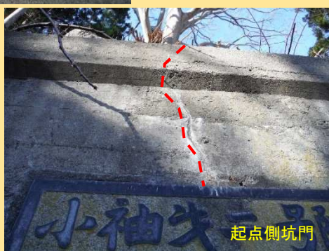
小袖第二号隧道の坑門工に発生したコンクリートのひび割れ。監視を継続する。
