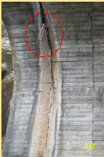
小袖第一号隧道の入口付近に発生した漏水。監視を継続する。
