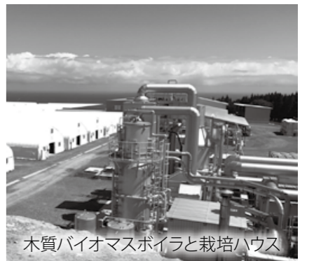
木質バイオマスボイラと栽培ハウス
