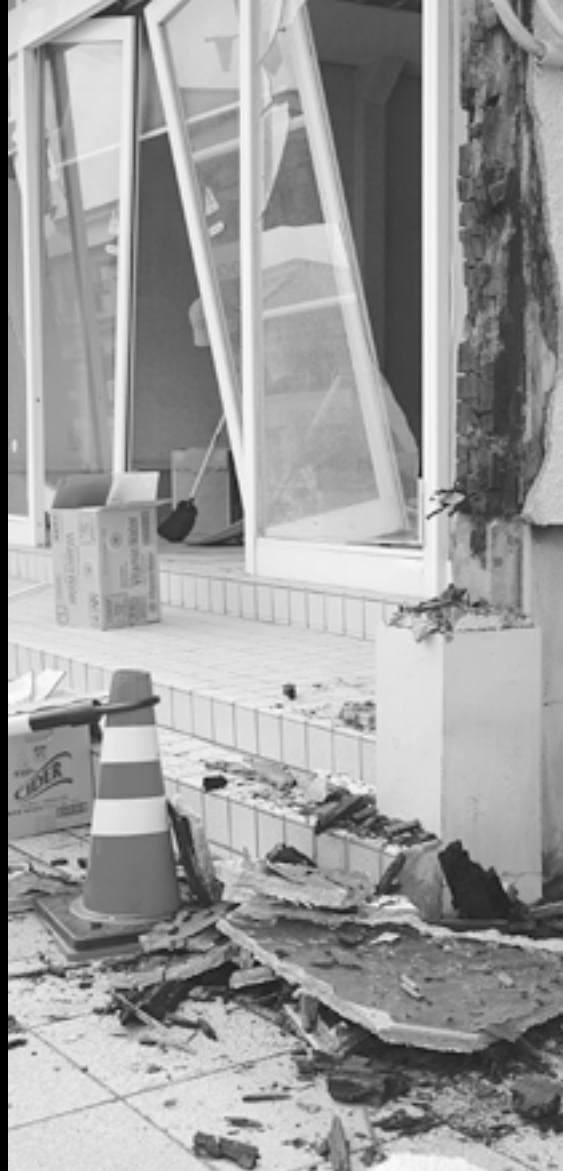
被害にあった八日町の店舗。崩れ落ちた壁が揺れの強さを物語ります
