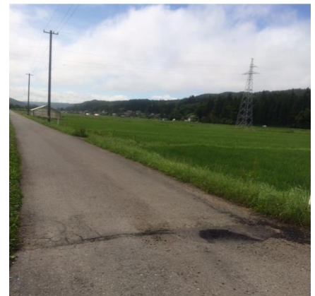
令和2年7月、夏井市民センター北側十字路付近の穴ぼこ。情報提供から1週間ほどで修理されました。とてもありがたいことです。
