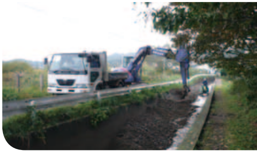
台風15号により土砂が堆積した沢里川
