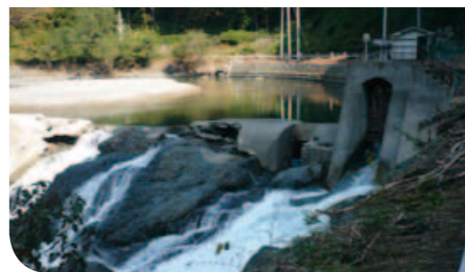
決壊した山口発電所のダム
