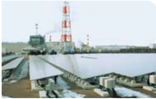
八戸市メガソーラー東北電力「八戸太陽光発電所」
