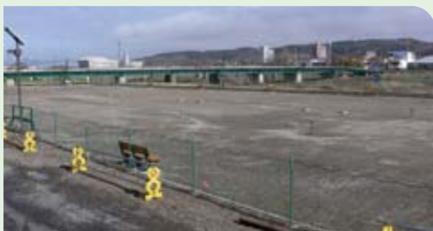
災害復旧中の河川公園テニスコート
