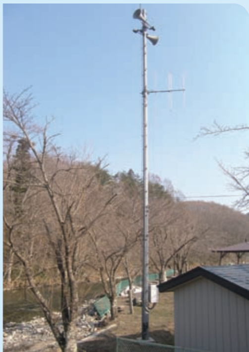
デジタル化される防災行政無線施設
