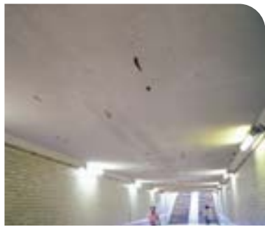
補修が必要な地下道天井
