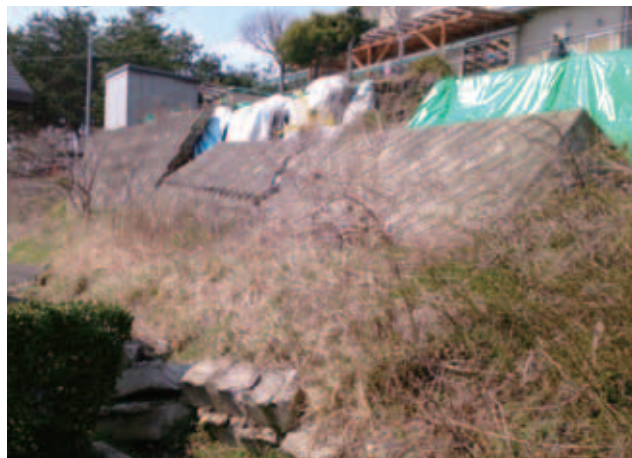
梅ヶ丘団地のり面崩落箇所の状況
