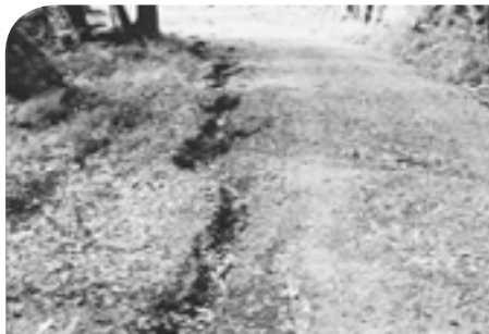
早期改良整備が望まれる市道間木平線
