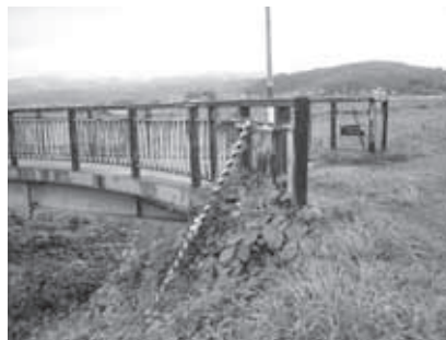
早期補修が必要な田沢川歩道橋
