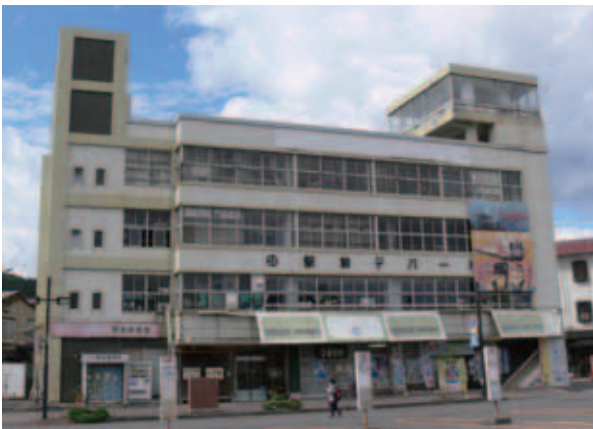
老朽化により早急な対応が求められる久慈駅前ビル
