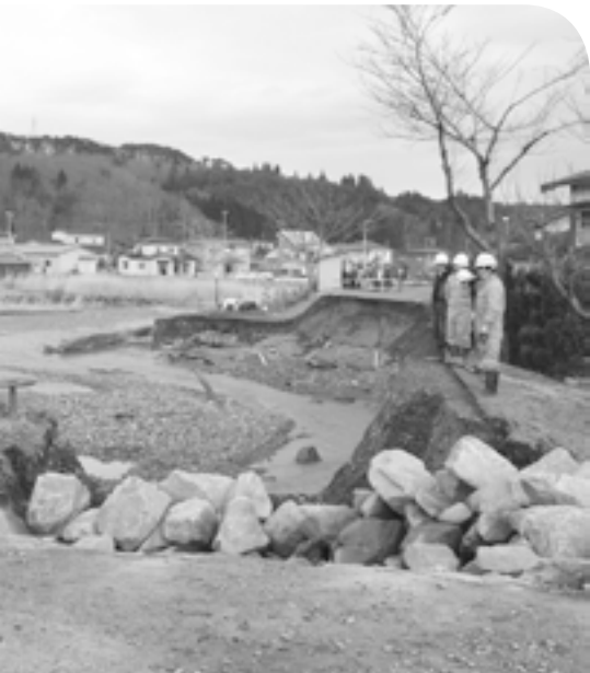
大きな災害が発生（夏井町田沢地区）
