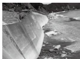
砂利が流出して擁壁の低部が露出した県道野田長内線
