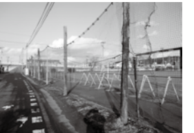
老朽化が進む長内小学校の防球ネットの木柱
