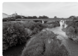
土砂の堆積や支障木が目立つ長内橋付近の長内川
