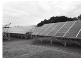
再生可能エネルギー発電等設備の一つ、太陽光発電所
