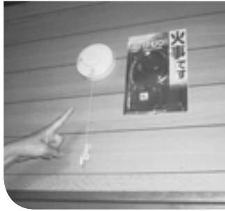
室内に設置された火災報知機
