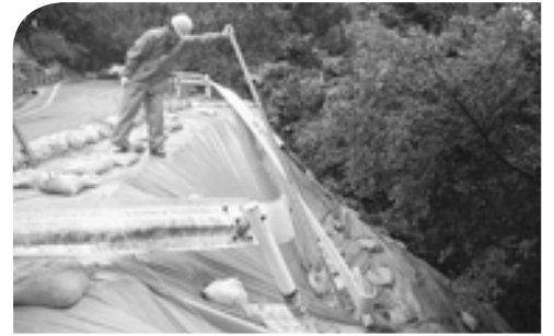
ブルーシートで保護された崩落現場
