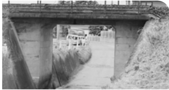
出水対策が望まれる三陸鉄道ガード下の市道
