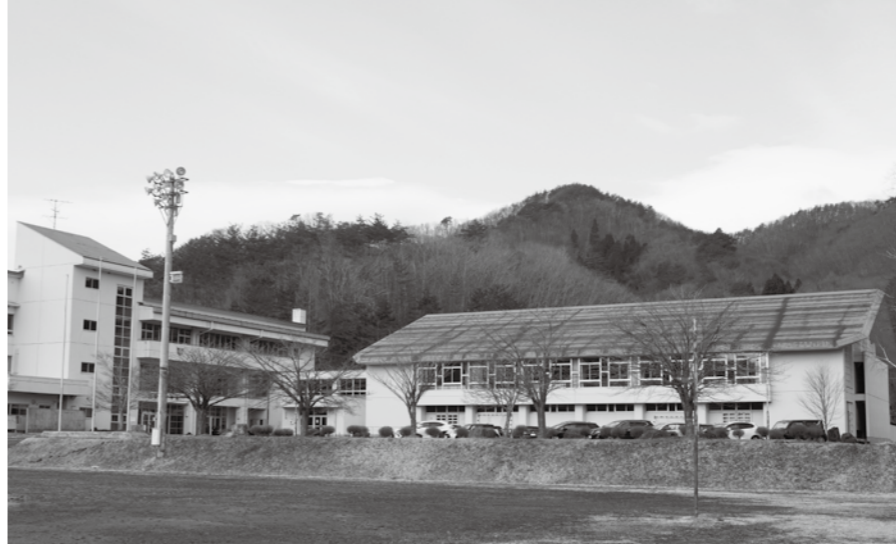
屋根の改修が必要な山形中学校
