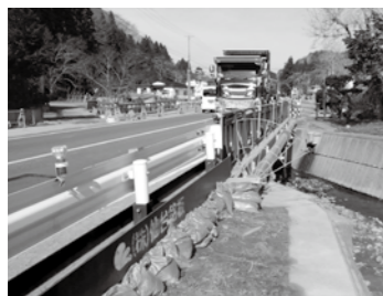
台風第19号で被災した北の越地区の国道45号沿い
