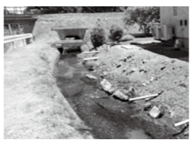
側溝が破損している市道上長内線沿いの農業用水路
