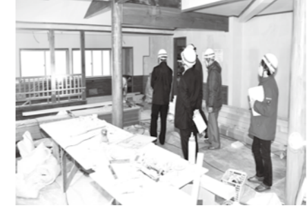
オープンに向け浴室の改修工事が進む新山根温泉「べっぴんの湯」
